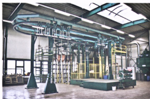
Entschichtungsanlage mit Gestellspeicher
