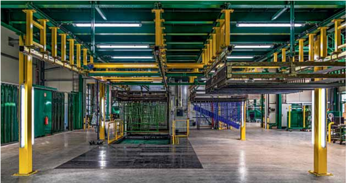
Die zusätzliche Beschichtungsanlage von ARTIMAX mit drei verschiebbaren Beschichtungsbecken.
